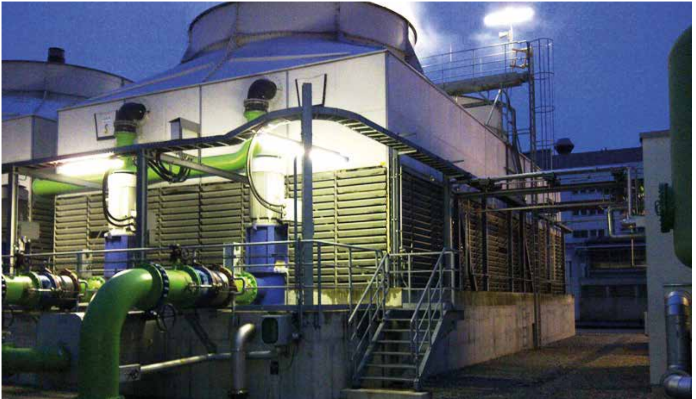
Fig. 2: Las torres de refrigeración en el parque químico Gendorf Industrial Park. Las transmisiones de las torres y bombas de refrigeración se controlan de forma inalámbrica.
